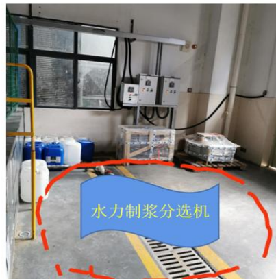
水力制浆分选机：位于除臭风机房内
